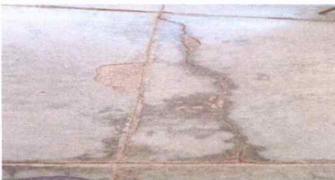
Foto 5: MODULO 5, PISO DE CONCRETO DETERIORADO
