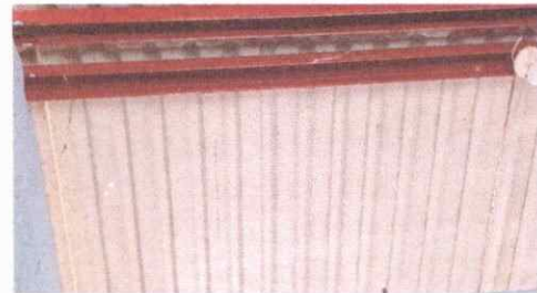
Foto 4: MODULO 4 LAMINAS DETERIORADAS
