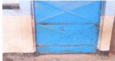
Foto 2: FOTOGRAFIA DEL MODULO 2 PUERTAS DETERIORADAS
